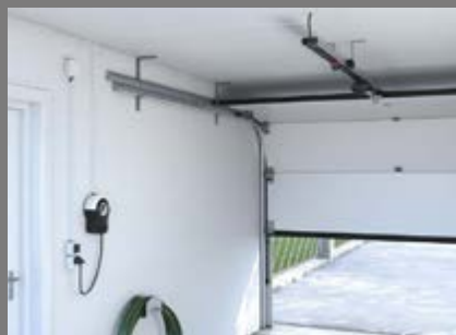
Řídicí jednotka v prostoru garáže
